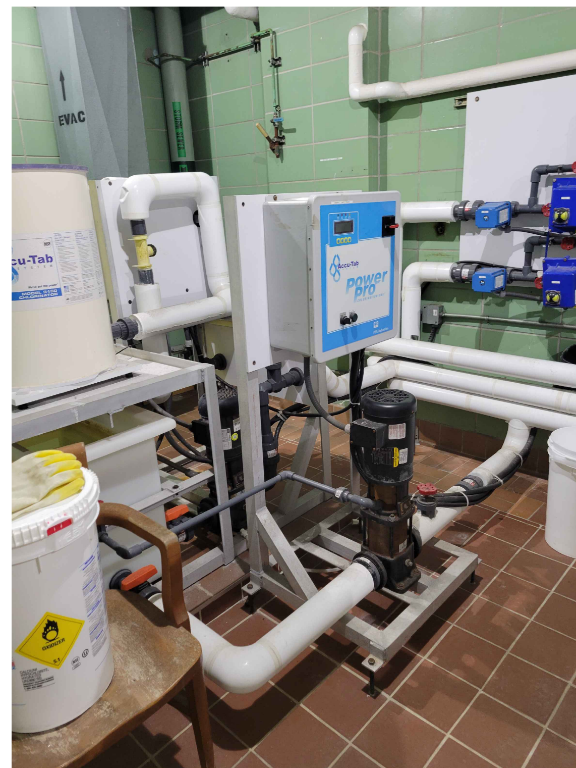
PHOTO #2 / PICTURE #2 PANNEAU TYPIQUE DES CHLORINATEURS À DÉBRANCHER (4x) / TYPICAL CHLORINATOR PANEL TO DISCONNECT (4x)
