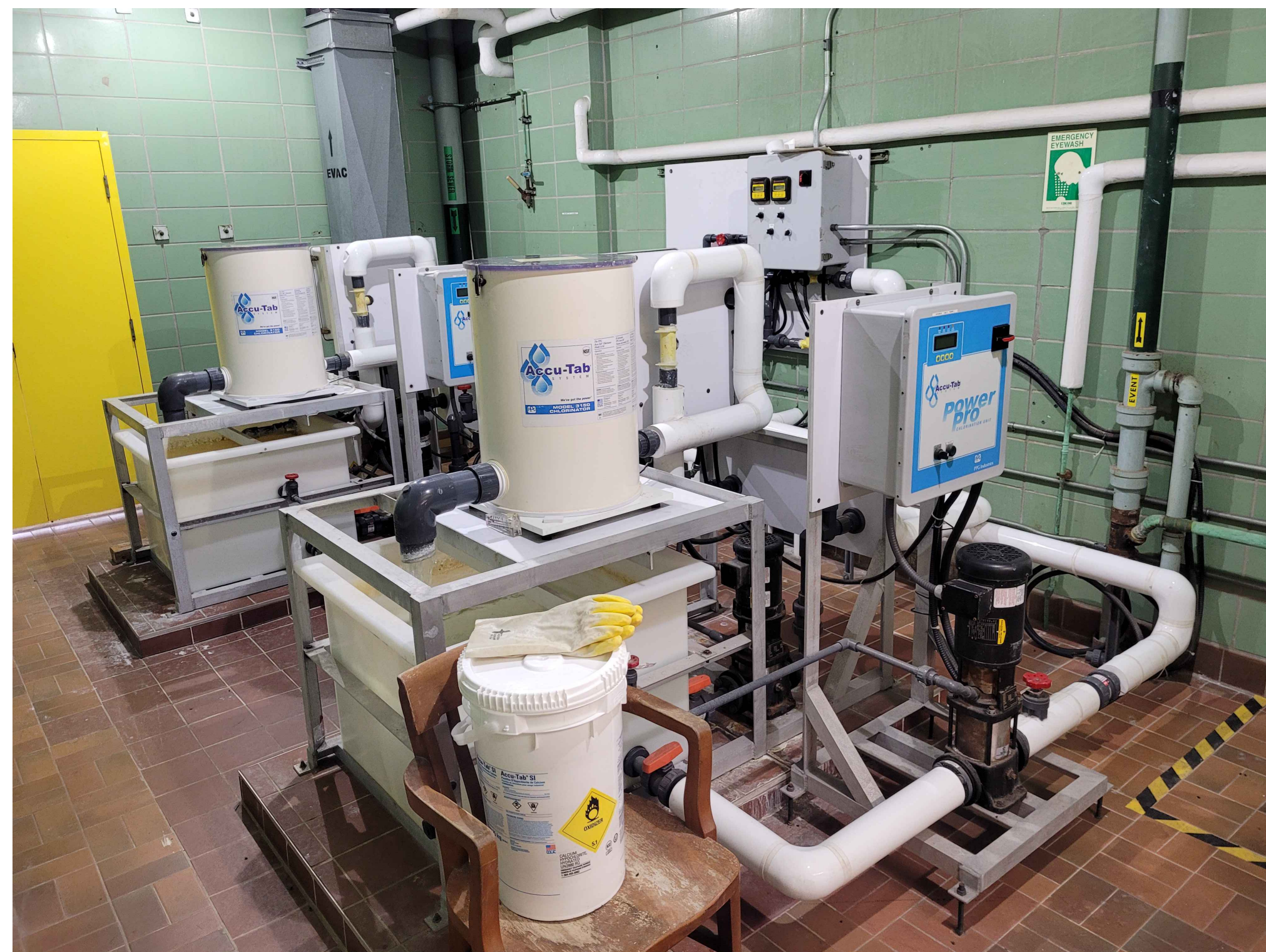
PHOTO #1 / PICTURE #1 VUE DE LA SALLE DE CHLORINATION / CHLORINATION ROOM
