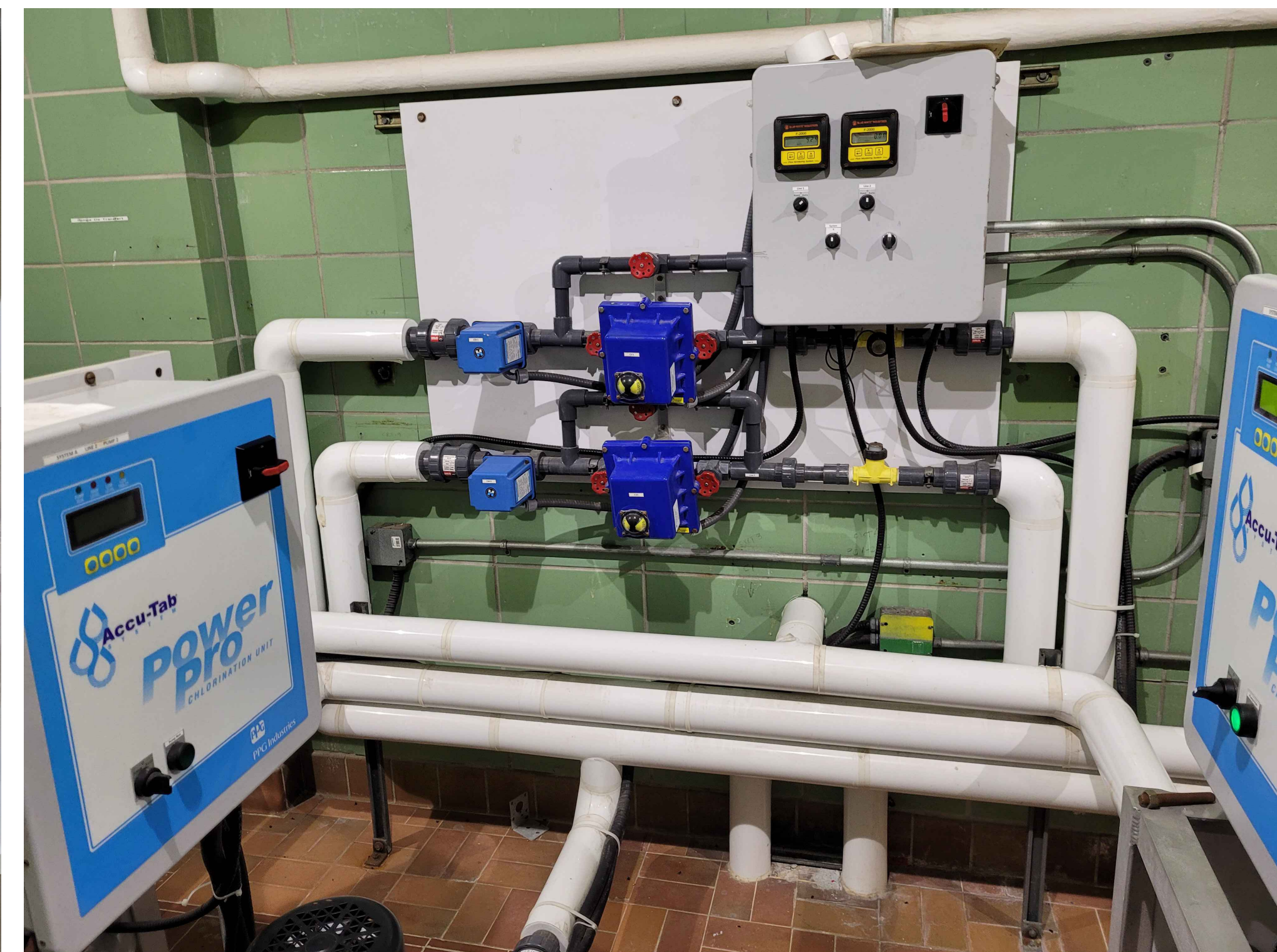
PHOTO #4 / PICTURE #4 PANNEAU DES DÉBITMÈTRES (AU MUR) À DÉBRANCHER (1x) / FLOWMETER POWER PANEL (ON WALL) TO DISCONNECT (1x)
