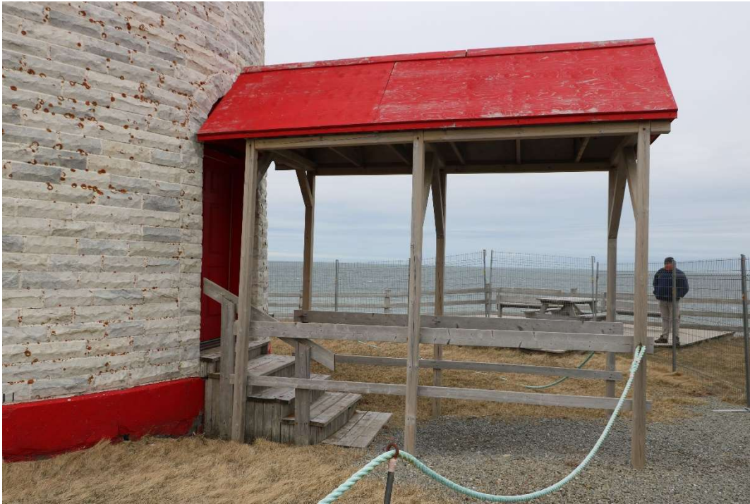
Figure 24 : Abri de bois à démanteler et disposer
