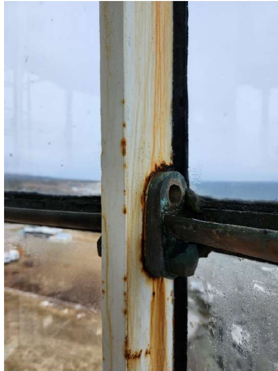
Figure 13 : Boulons manquant à certaines jonctions entre les traverses horizontales et les montants verticaux structuraux
