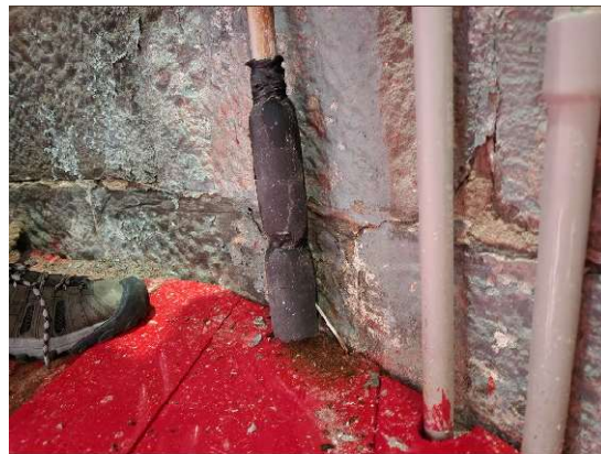
Figure 32 : Conduit protecteur de fil électrique brisé à réparer.
