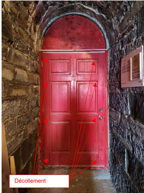
Figure 20 : Panneau de porte – recoller toutes les jonctions à chaque de chaque planche.
