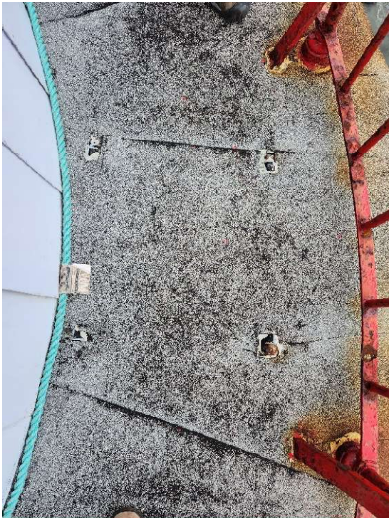
Figure 27 : Ancrages vétustes à retirer
