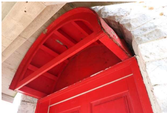
Figure 22 : Structure de support du parement de pierre en demi-cercle à refaire et intégrer avec la nouvelle imposte.
