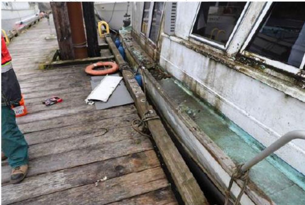
Image 2 : Montego Bay (Côté tribord, section du pont pourri)
