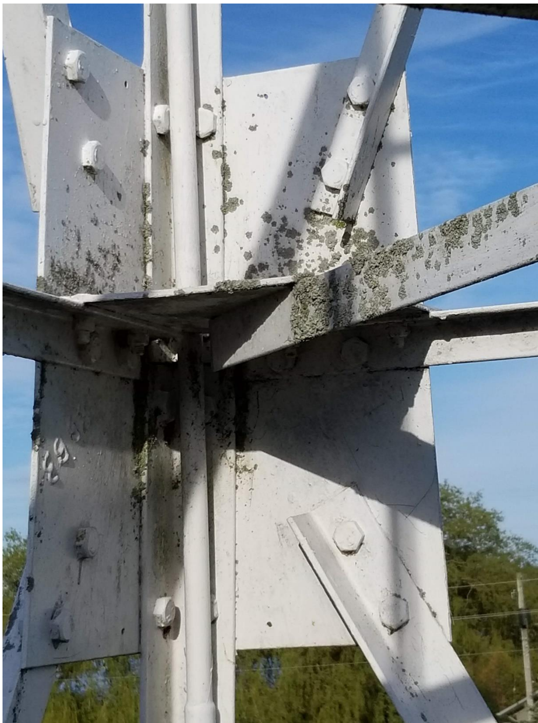
Figure 17 : Phare d'alignement postérieur LL488 de Brighton existant – Raccordement des éléments de structure
