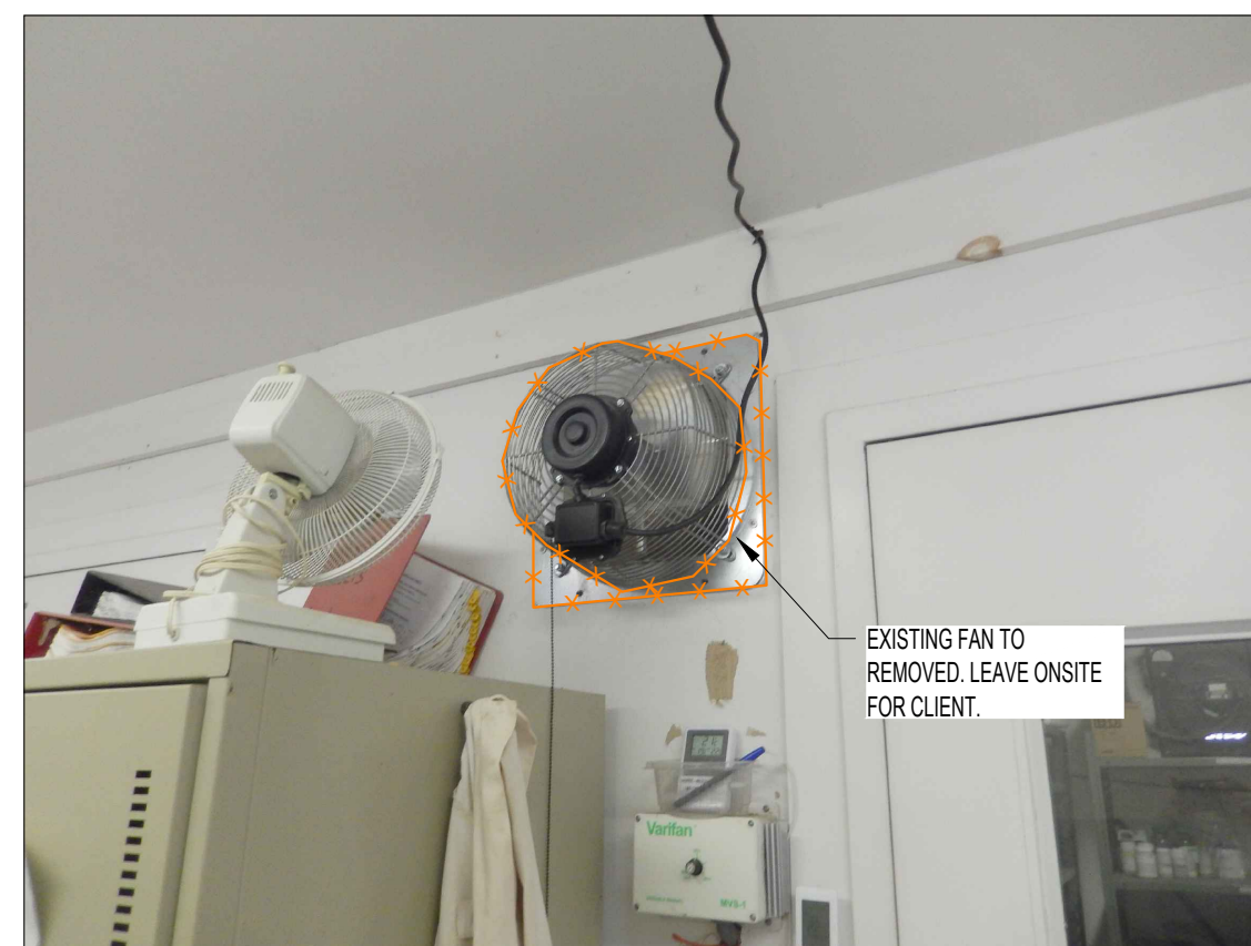
IMAGE #1: EXISTING FAN
