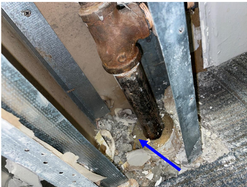
Figure 5: Photographie représentative des débris de ciment observés aux pénétrations des tuyaux au 2 e étage adjacent à la cuisine. Les débris cimentaires ont été échantillonnés et confirmés comme ne contenant pas d'amiante (ID de l'échantillon : AS-05A-C).
