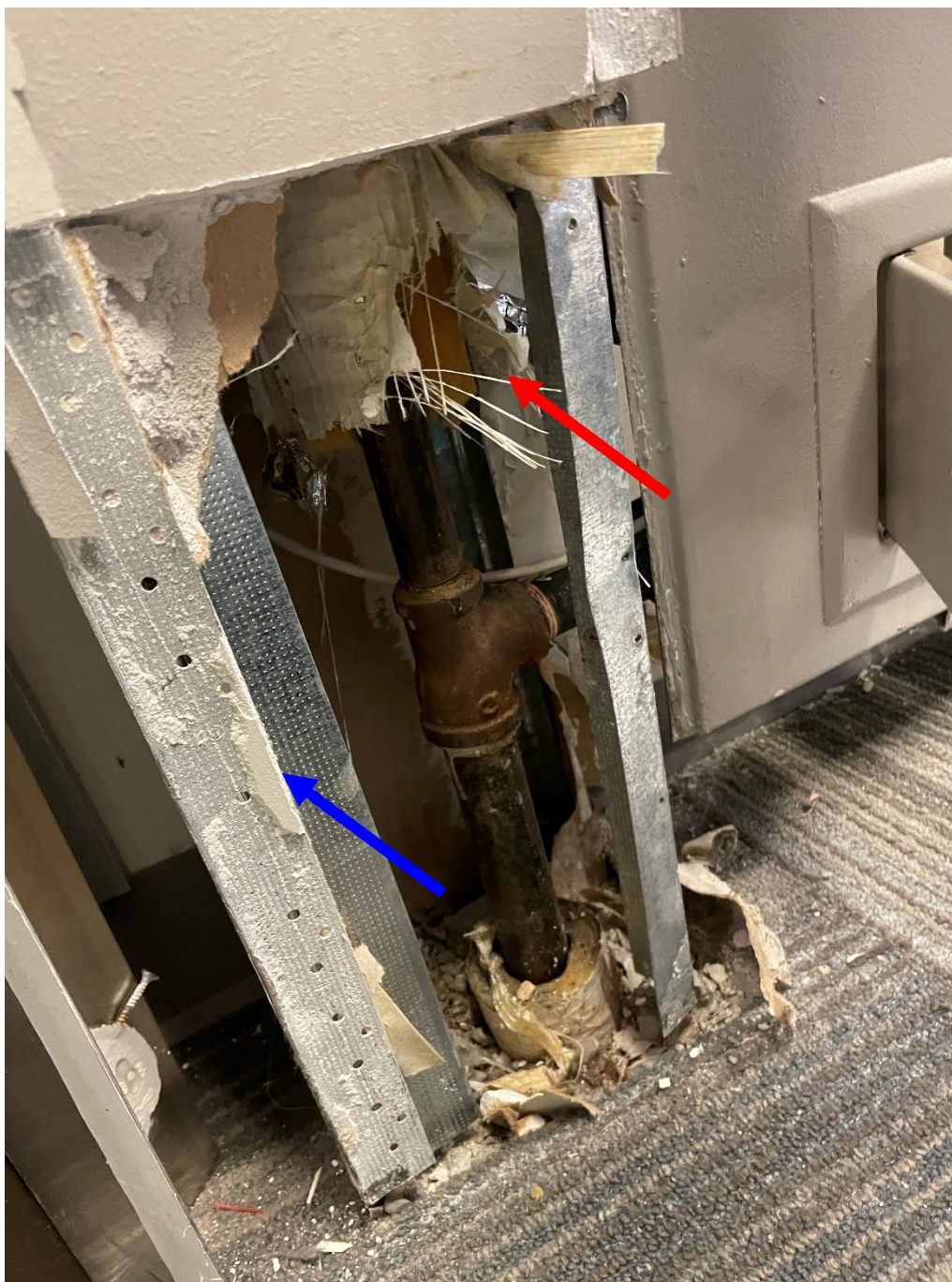
Figure 4: Photographie représentative du composé à joints pour cloisons sèches (flèche bleue) observé en « mauvais état » au 2 e étage au niveau des pénétrations de tuyaux. Le composé à joints pour cloisons sèches a été échantillonné et confirmé comme ne contenant pas d'amiante (ID de l'échantillon : AS-04A-C). L'isolant en fibre de verre (flèche rouge) a été échantillonné conformément à la demande du client et confirmé comme ne contenant pas d'amiante (ID de l'échantillon : AS-06A-C).
