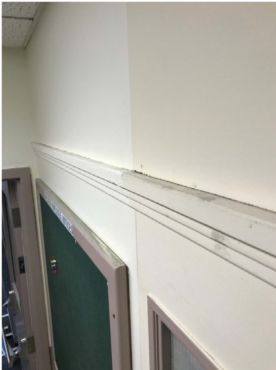
Photo 4 : panneaux en amiante ciment Transite observés sur le mur entre les salles 152 et 151 contiennent 1 % d'amiante de type chrysotile (échantillon Historical Oakhill 9698-U61 10A-C).
