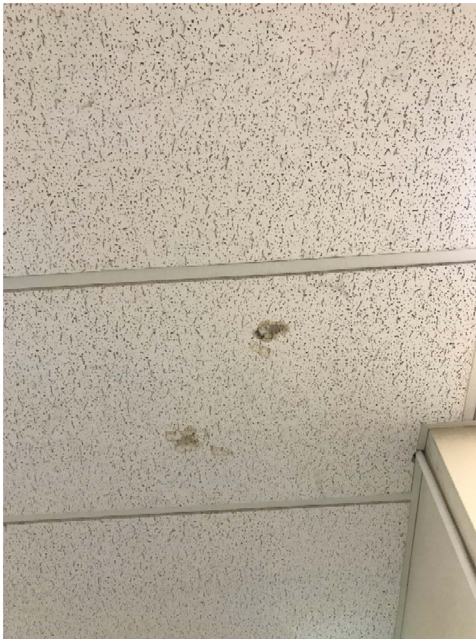
Photo 6 : suspicion de moisissure présente sur les tuiles acoustiques de la salle 152.
