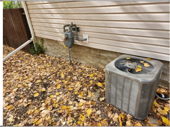
Gas meter & Air Conditioning Unit (South corner) - Compteur de gaz et unité de climatisation (coin sud)
